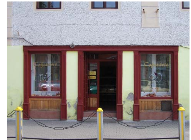
Fig. 2.130 În acest caz reamenajarea vitrinelor a condus la o influențare negativă a aspectului inițial: suprafața deasupra ferestrelor prevăzută pentru reclamă a fost îndepărtată, iar soclul a fost modificat în mod neadecvat.
