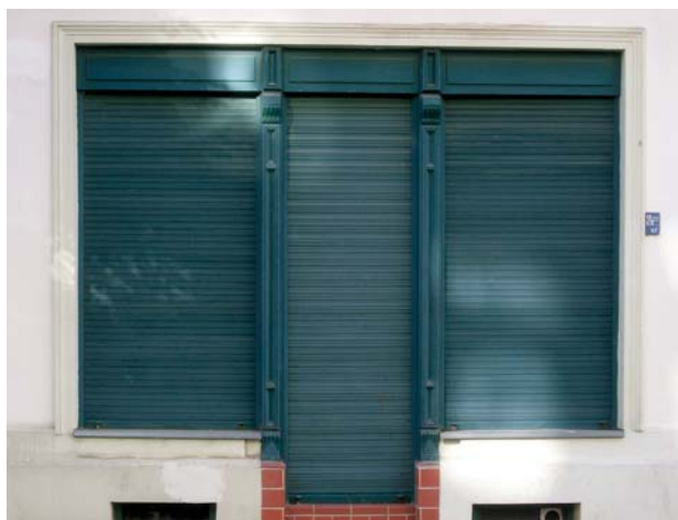
Fig. 2.110 Rulourile din lemn ale acestei vitrine compuse simetric, oferă o protecție sigură în timpul în care magazinul nu este deschis. Și în acest caz, rulourile sunt mascate complet de elementul de acoperire din lemn, în formă de ladă, al vitrinei.
