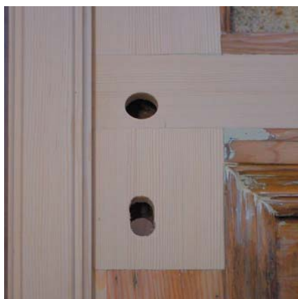
Carcasa broaștei deteriorată, după reparație profesională
